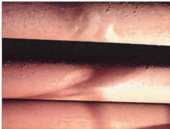
Depuneri pe partea superioară a țevilor cauzate de particule în suspensie și compușii fierului ce dau culoarea roșie
