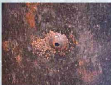
Coroziune locală datorată cuprului
